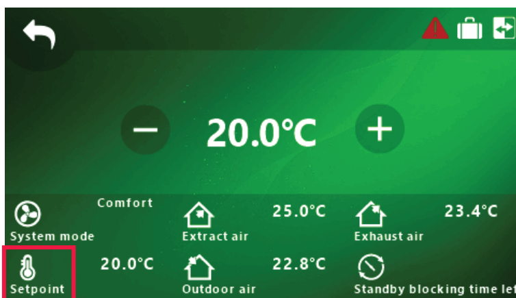
Afb. 5.6.1.4 Schermweergave ST-SA-Control en SALDA AIR temperatuur instelpunt
